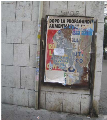
Viale Marconi: impianto fatiscente
