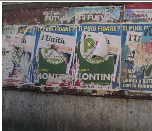
Viale Trastevere: impianti fatiscenti
