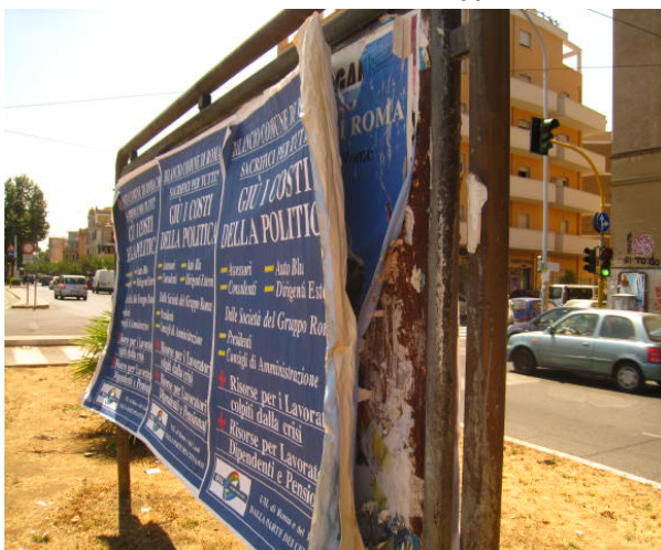
Piazza San Giovanni di Dio: impianto arrugginito e manifesti scollati
