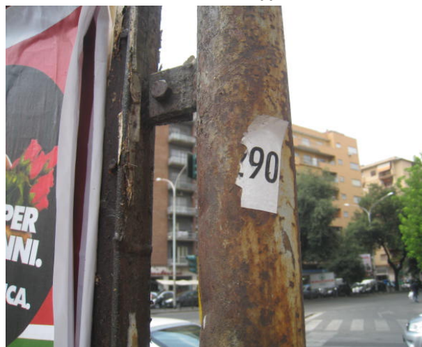
Viale Marconi: impianto arrugginito (particolare)
