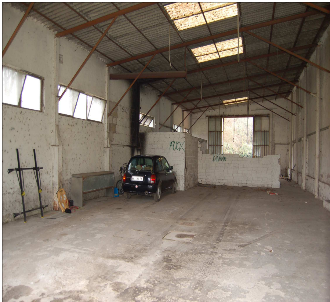
Interno del fabbricato più retrostante a destra dell'entrata (part. 48, sub 2 di mq. 216)
